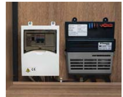
+ 12-Volt-Stromversorgung mit LED-Anzeige bei defekter Sicherung
