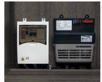
+ 12-Volt-Stromversorgung mit LED-Anzeige bei defekter Sicherung
